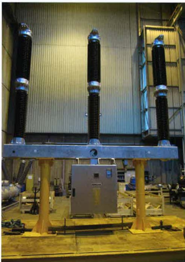
Obr. 1 Vypínač 8E1-II 123 kV Fig. 1 Circuit-breaker 8E1-II 123 kV
